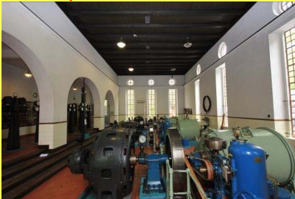
Turbinehallen på Harteværket.
